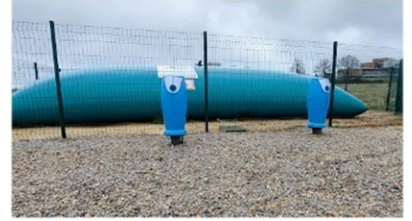
Raccord poteau incendie
